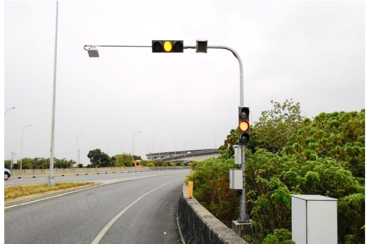
電子標籤偵測器與匝道儀控號誌燈共架
