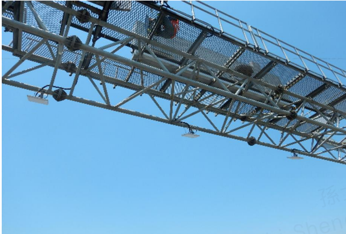
電子標籤偵測器與主線資訊可變標誌共架
