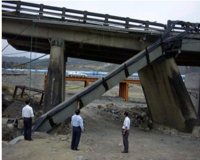
圖 4、橋梁斷裂導致線路中斷
