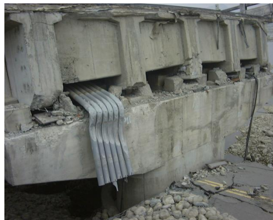
圖 3、橋梁損毀導致通訊線路損毀
