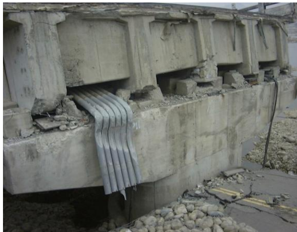
圖 3 橋梁斷裂導致實體線路斷裂
