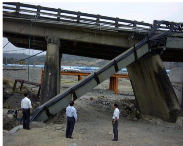
圖 4 建物結構毀損導致實體通訊線路斷裂
