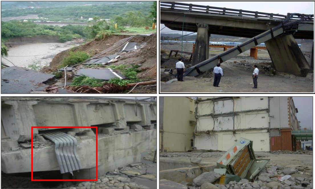
圖 1.1、通訊線路於災害中受損
